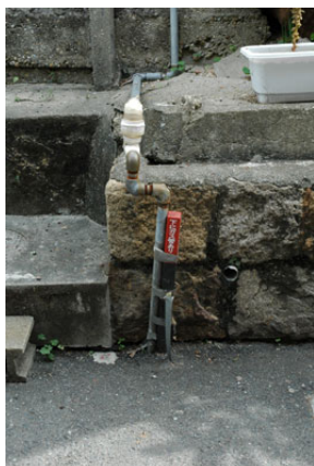
この下ガス管の表示。地形が複雑なので配管も難しいのか・・・
