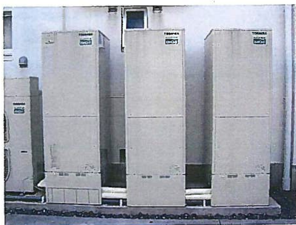
シャワー用にエコキュート(560ℓ×3台)を設置 7
