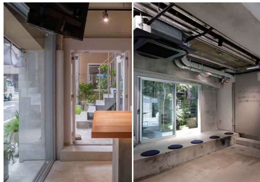
左：鉄筋コンクリート造ラウンジより増築部ロティを見る。壁を抜いた分、柱巻き補強を行った。／右：鉄筋コンクリート造ラウンジより庭越しにT-HOUSE（本誌2010）を見る。T-HOUSEも安田不動産による日本橋浜町の一連の再開発。*
